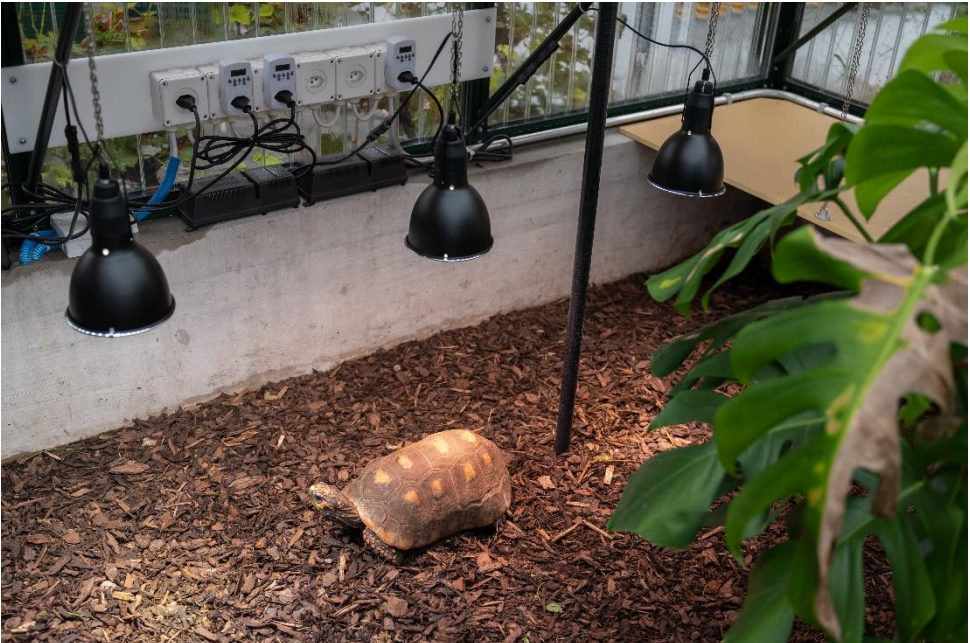
Die elektrische Installation befindet sich unterhalb der Pflanzentische.
