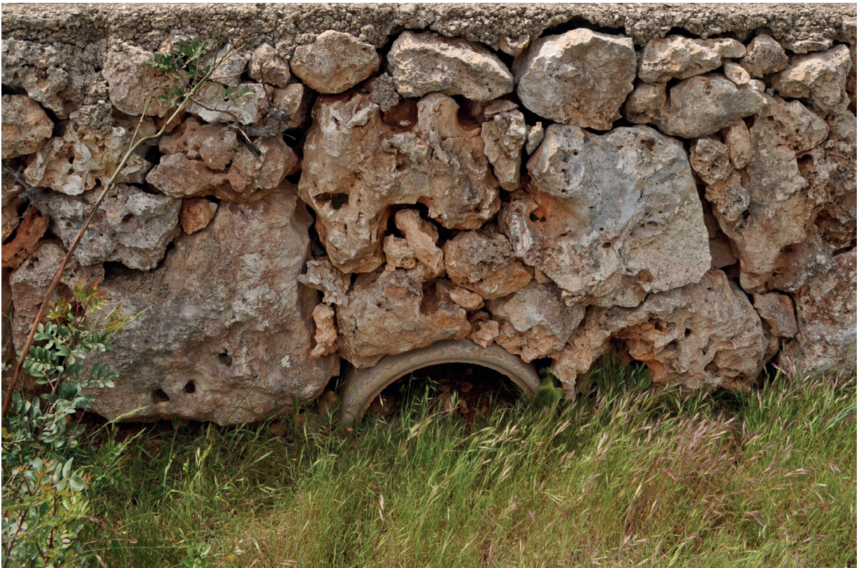
Abb. 8e: Dieser Entwässerungstunnel wird von den Schildkröten vermutlich als Durchgang genutzt.
