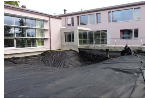
Abb. 6: Die fertig ausgebreitete Folie. Der Pfeiler wurde mit einer Manschette verkleidet. An den Betonwänden des Gebäudes wurde die Folie angeklebt und oben mit Pressschienen fixiert. Foto: Markus Kutzli
